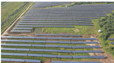
恒邦光伏发电装置
