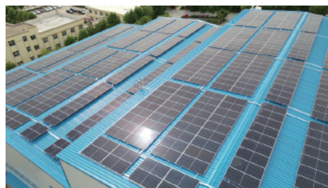
中金黄金股份有限公司山东鑫泰选矿厂厂房顶安装的“分布式光伏发电系统”
